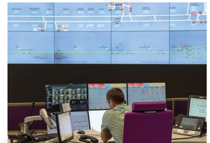
Poste de commande centralisé (PCC) ligne 4.
