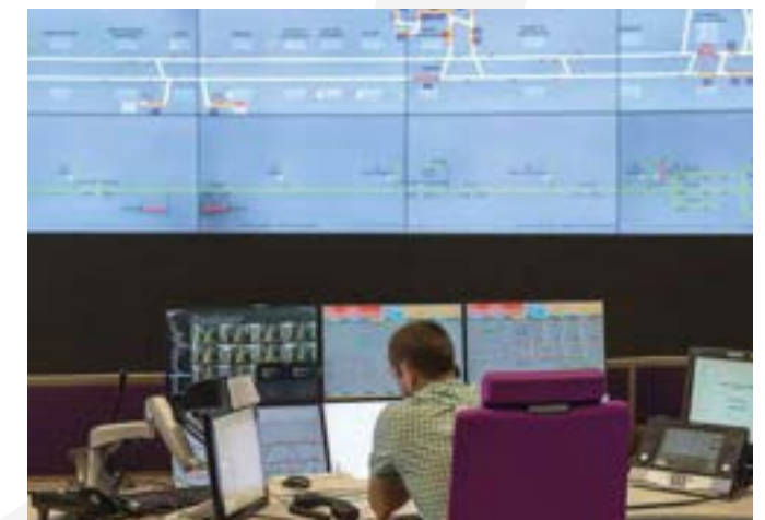
Poste de commande centralisé (PCC) ligne 4.
